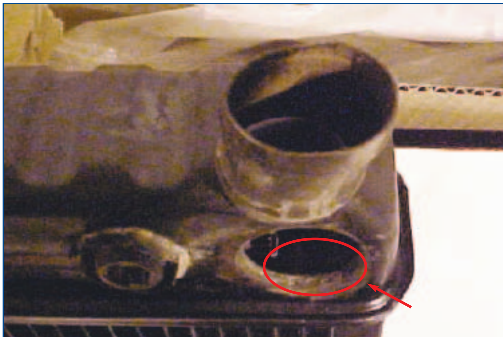
Connection lâche ou brisée causée par une soudure inadéquate
