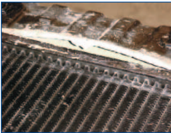
Joint de soudure éclaté
